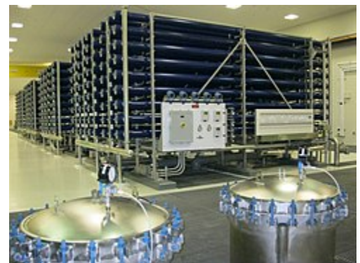
آرایه ای از فیلترهای گذرندگی وارون در یک کارخانه آب شیرین کن
